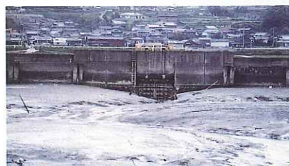
樋門に押し寄せたガタ土の状況（海側）
